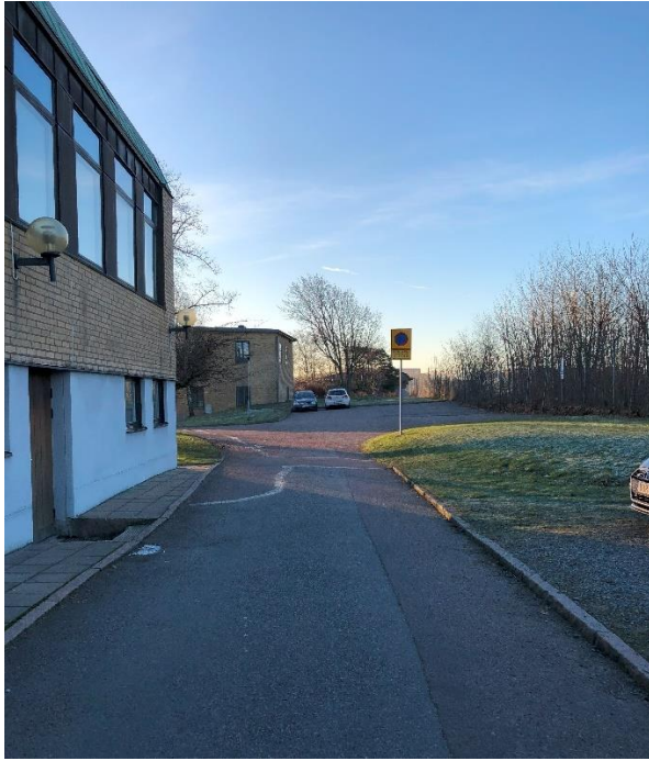
Figur 6. Fotot taget i sydlig riktning längs skolbyggnadens västra fasad längs vilken en kantsten löper. Parkeringsytor, som skymtar till höger i bilden, och gatuytor sluttar mot kantstenen.
